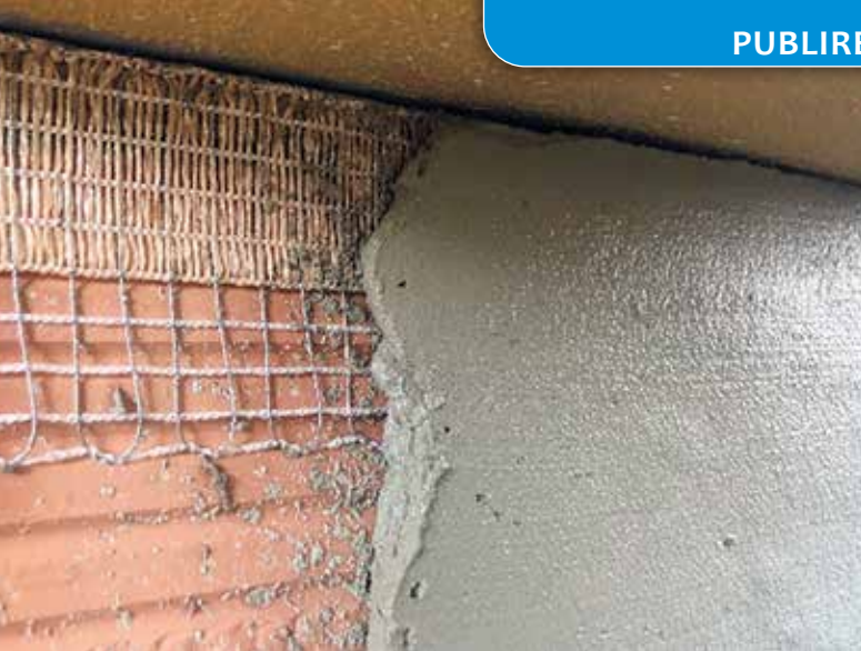
EasyFix lors du passage du mur au plafond. L'enduit de base s'accroche à la maçonnerie dans la partie inférieure, mais n'adhère que sur le treillis dense dans la partie supérieure.
